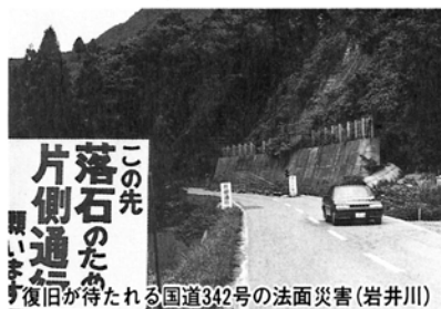
この先落石のため片側通行が困難な国道342号の法面災害(岩井川)
