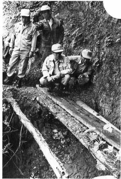
決壊により水路管が成瀬川へ落下寸前 (橋台・明通り)
