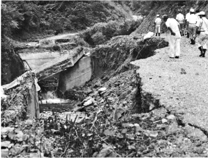
豪雨により流失した長倉上橋
