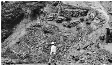
菅ノ台側の危険な落石ヶ所
