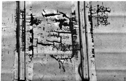
屋根のひび割れ、はげ落ちた部分
