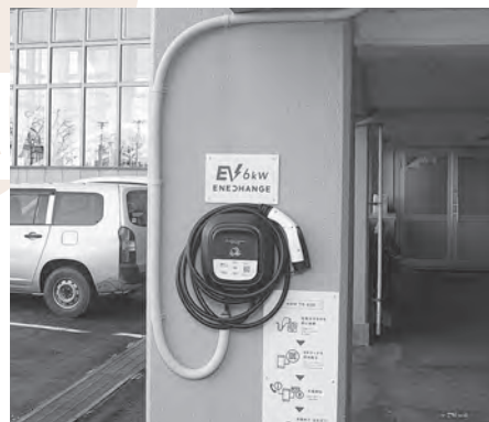
▲役場庁舎に設置されたEV充電設備
