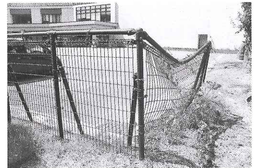
雪で破損したフェンス
