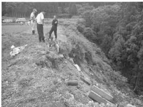
崩れ落ちた側溝（入道）
