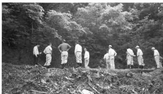
手倉・柳沢地内の水路崩落現場
