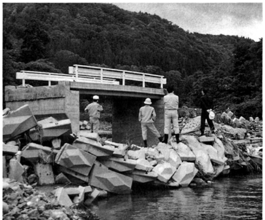
台風で前後の道路が流された (樺川・古川地内)
