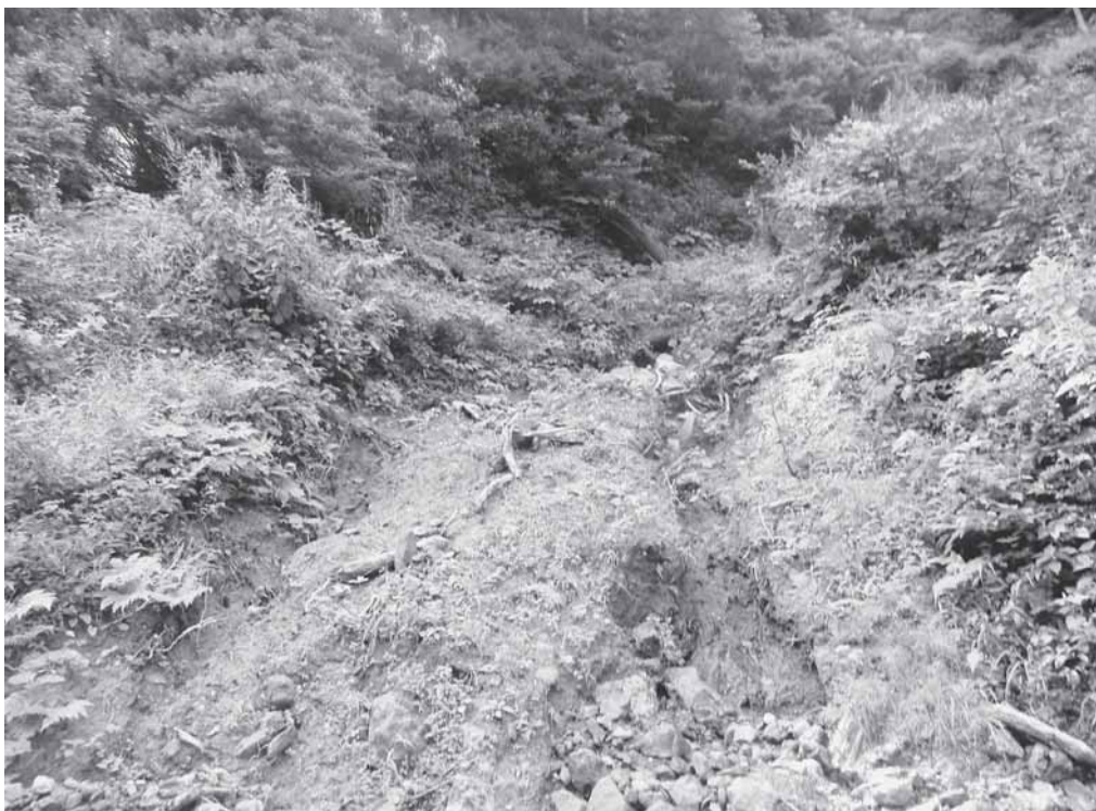
通行止めの状態が続く林道一ノ沢線（田子内）
