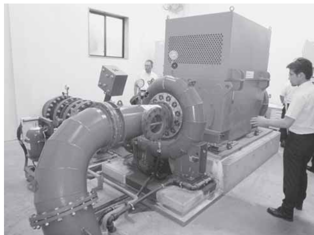
一般家庭約650軒分を発電する発電機
