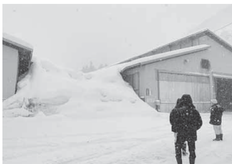
軒が壊れた畜舎
