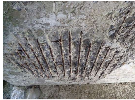
床版の鉄筋露出
