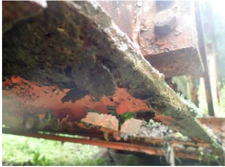
主構トラスの腐食
