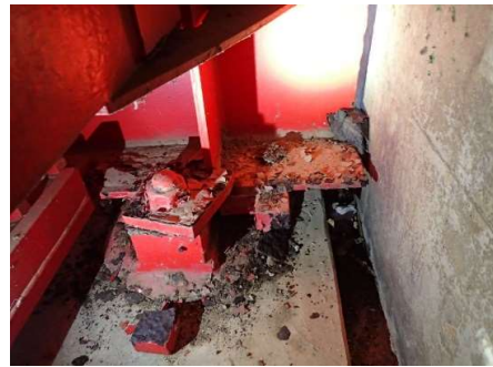
支承（上沓ストッパー部）の破断
