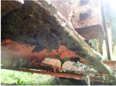
主構トラスの腐食
