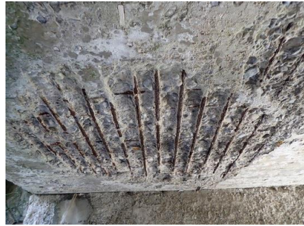
床版の鉄筋露出
