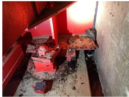
支承（上沓ストッパー部）の破断
